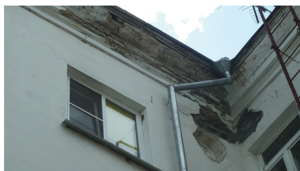
Рисунок 2 — Разрушение карниза и стены по дворовому фасаду
