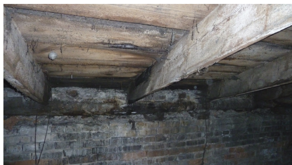
Рисунок 1 — Следы протечек дождевой воды в узле опирания стропильной ноги на мауэрлат
